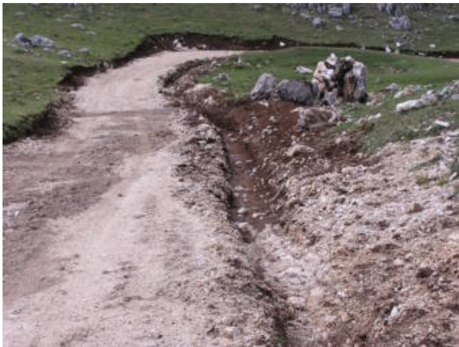
Celano – Loc. Fonte Vallone Fatto – Un tratto in salita della pista che prima della sistemazione era con fondo in terra e risultava scarsamente agevole e “giustificava” il fuori pista- Con i lavori è stato ricaricato il fondo con pietrisco sono stati sistemati dei tagliacqua in ferro e realizzato delle canalette laterali per lo scolo delle acque superficiali convogliate
