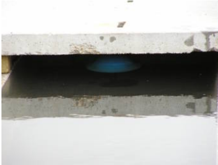
Celano – Loc. Fonte Monacesca . Il fontanile dispone di un sistema a galleggiante (protetto da una copertura in cemento) che regola l'afflusso di acqua quando si abbassa il livello e lo blocca quando arriva al margine
